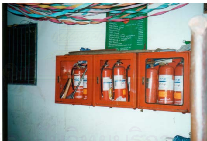
ภาพที่ 4-17 แสดงการมีอุปกรณ์ป้องกันอัคคีภัยในชุมชน
