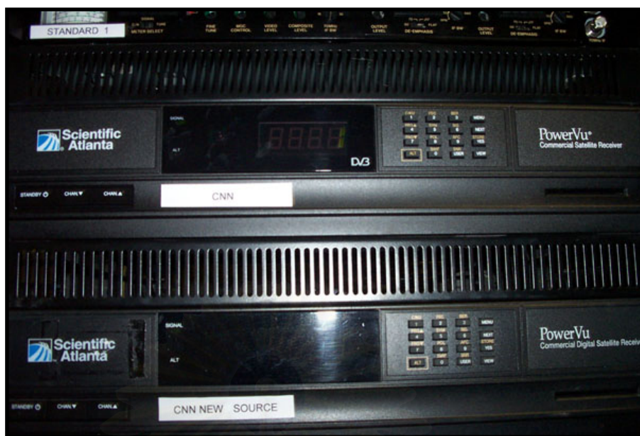
ภาพที่ 30 แสดงการติดตั้งอุปกรณ์รับและถอดรหัสสัญญาณ สถานีโทรทัศน์ไอทีวี
