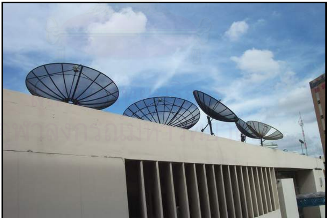
ภาพที่ 25 แสดงการติดตั้งจานดาวเทียมเพื่อรับสัญญาณของสถานีโทรทัศน์สีช่อง 9 อ.ส.ม.ท.
