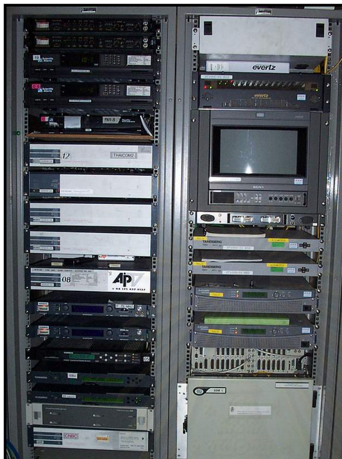
ภาพที่ 26 แสดงการติดตั้งอุปกรณ์รับและถอดรหัสสัญญาณ สถานีโทรทัศน์ช่อง 9 อ.ส.ม.ท.
