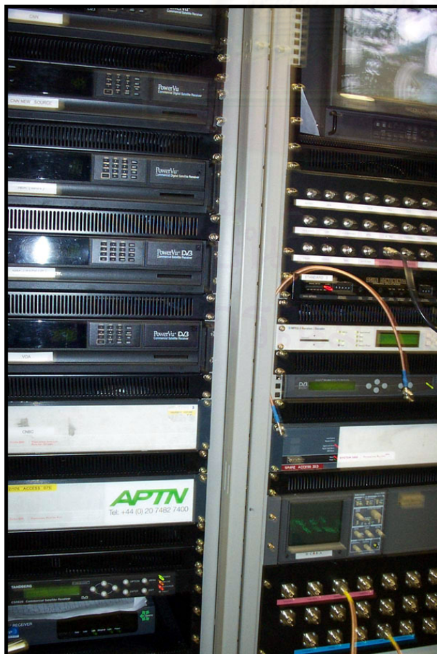
ภาพที่ 29 แสดงการติดตั้งอุปกรณ์รับและถอดสัญญาณ สถานีโทรทัศน์ไอทีวี
