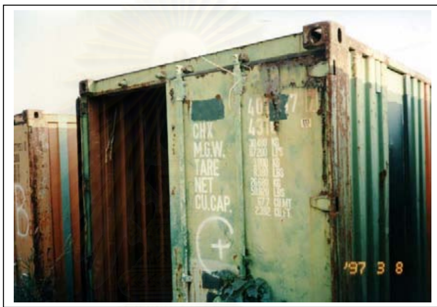
ภาพที่ 5.6 ตู้ที่ยังรอการซ่อมแซม หลังจากการยกขึ้นไปตั้งไว้บนเสาคอนกรีต
