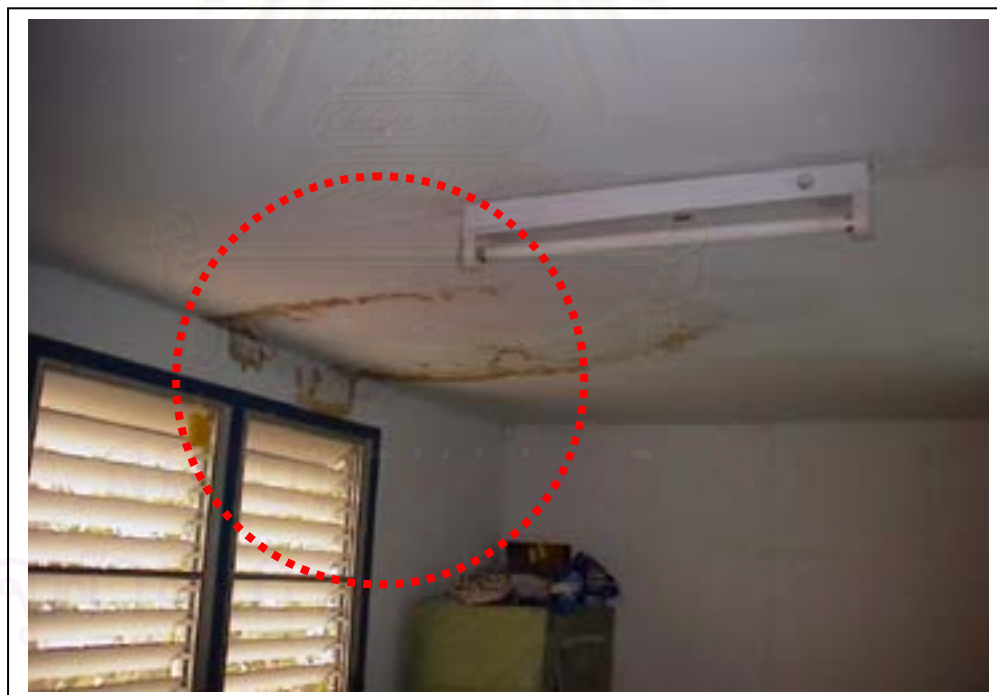
ภาพที่ 5.35 รอยน้ำซึมเข้าภายในห้องพัก
