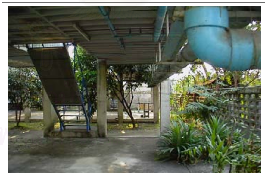
ภาพที่ 4.12 ลักษณะการเดินท่อน้ำเสียใต้ตู้คอนเทนเนอร์ที่ใช้พักอาศัย
