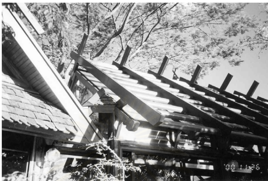
รูปที่ 3.8 แสดงโครงเหล็กบังแดดเหนือหลังคากระฉก
