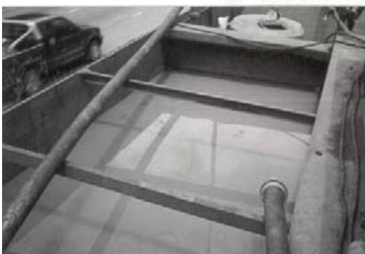
รูปที่ 2-14 ถังพักตะกอน (Sediment Tank)
