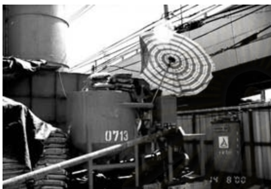
รูปที่ 2-4 ถังผสม (Recirculation Pump) ใช้ผสมสารละลาย
