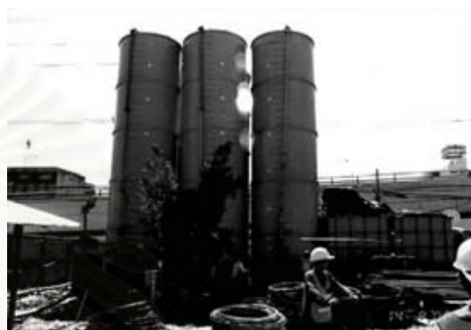
รูปที่ 2-5 ถังเก็บสารละลายเพื่อนำสู่หลุมเจาะ
