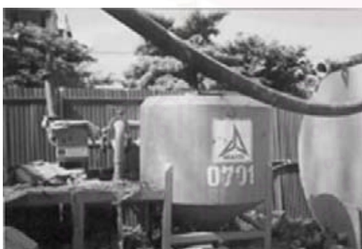
รูปที่ 4-30 ถังผสม (Recirculation Pump) ใช้ผสมสารละลายรักษาเสถียรภาพหลุมเจาะ
