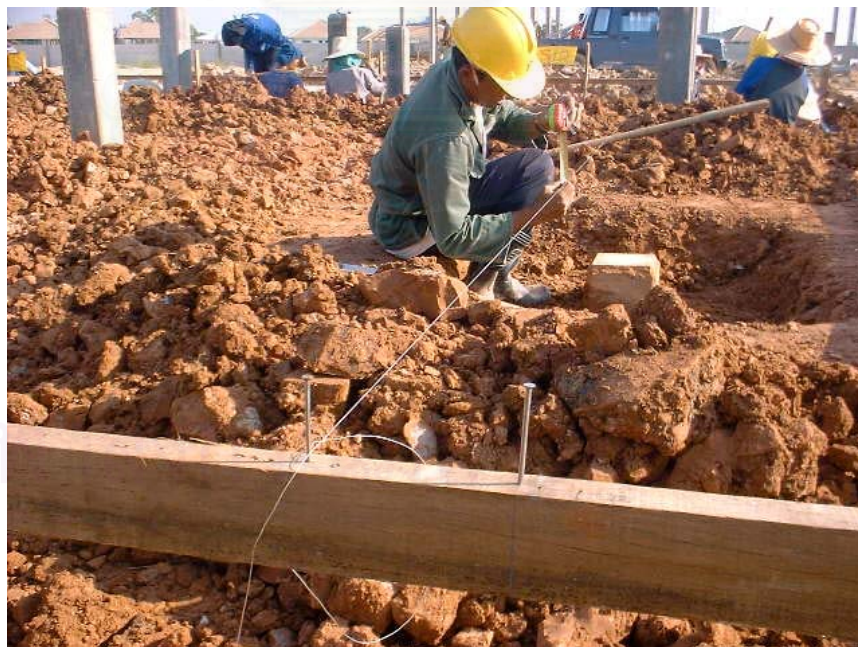
ภาพที่ 5.23 ช่างทำการตีฝั งวัดระดับเพื่อหาระดับฐานราก (วัดระยะลงไปหาตำแหน่งฐานราก) และหาแนวเส้นกึ่งกลางเสาชั้นที่ 1 ตำแหน่งที่จะฝั งหมุด บนฐานราก
