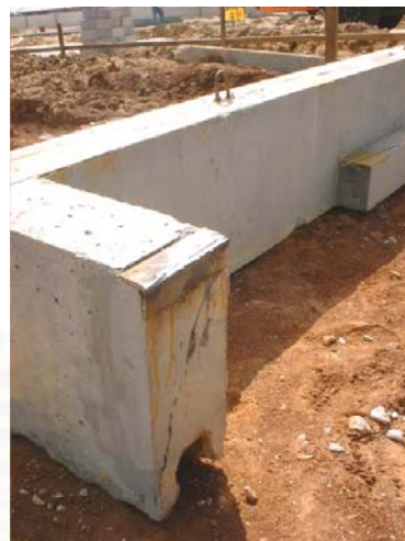
ภาพที่ 5.106 สภาพคานบันไดที่แตกร้าว
