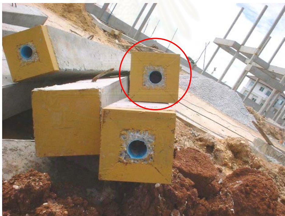
ภาพที่ 5.91 รูที่ปลายเสาเพื่อใช้ในการต่อเสาชั้นที่ 2 กับชั้นที่ 1 ไม่ตรงจุดกึ่งกลางเสา
