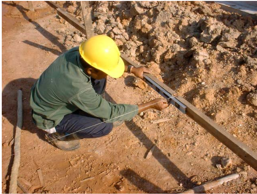
ภาพที่ 5.22 ช่างทำการบาคไม้ตีฝั ง ปรับระดับเอ็นให้ได้ระดับ ซึ่งระดับนี้ถ่ายมาจากถนน (ระดับสูงกว่าถนน + 0.50 ม. เป็นระดับพื้นชั้นที่ 1 )
