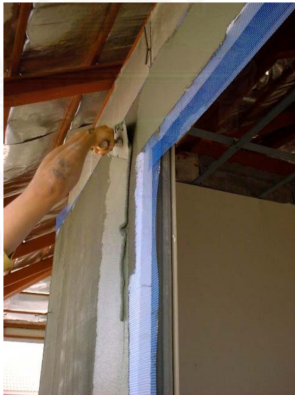
ภาพที่ 5.74 ช่างติดตาข่ายใยแก้ว และฉาบ Base Coat 2 รอบ
