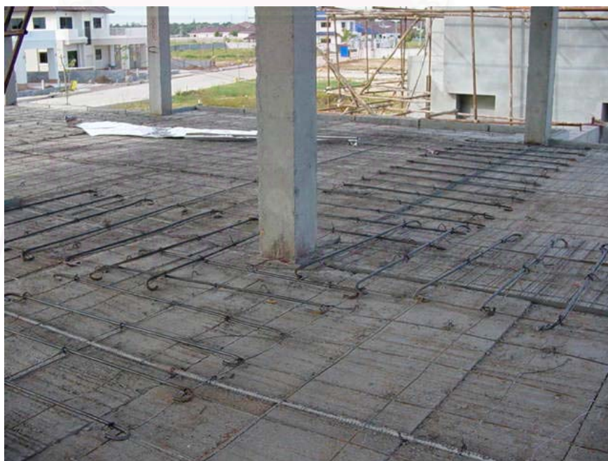
ภาพที่ 5.62 การเสริมเหล็กบนแผ่นพื้นสำเร็จรูปก่อนเทคอนกรีตทับหน้า
