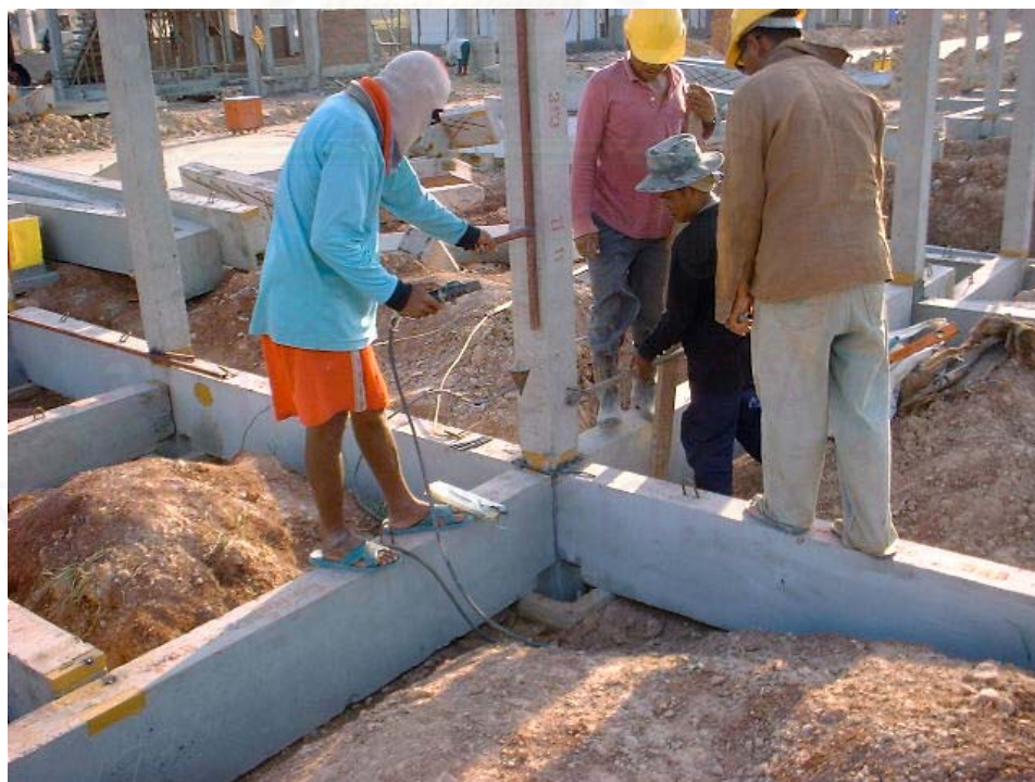
ภาพที่ 5.43 ช่างจัดปรับตั้งเสาและทำการเชื่อม
