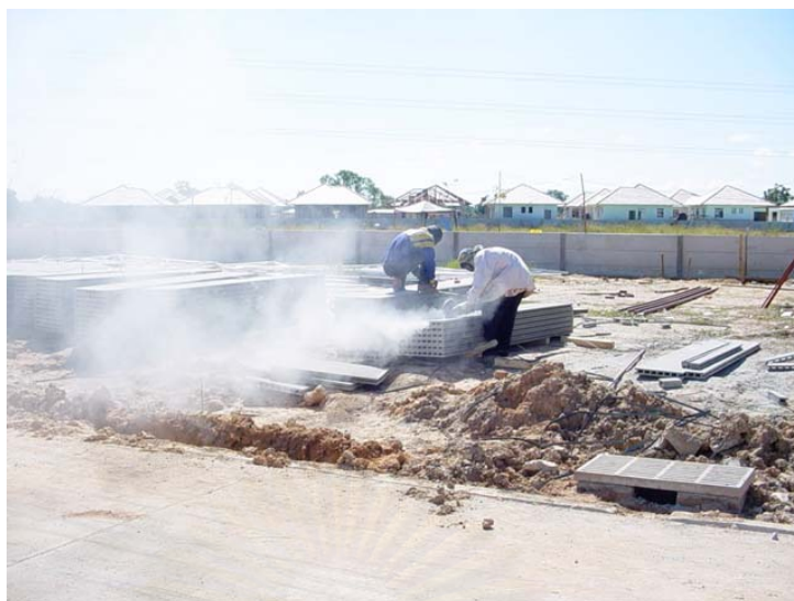
ภาพที่ 5.112 การตัดแต่งแผ่นที่หน้างานก่อให้เกิดฝุ่น เป็นมลพิษทางอากาศ
