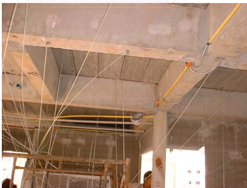
ภาพที่ 5.84 การเดินท่อร้อยสายไฟตามคานกระทำได้ตามกรรมวิธีทั่วไป
