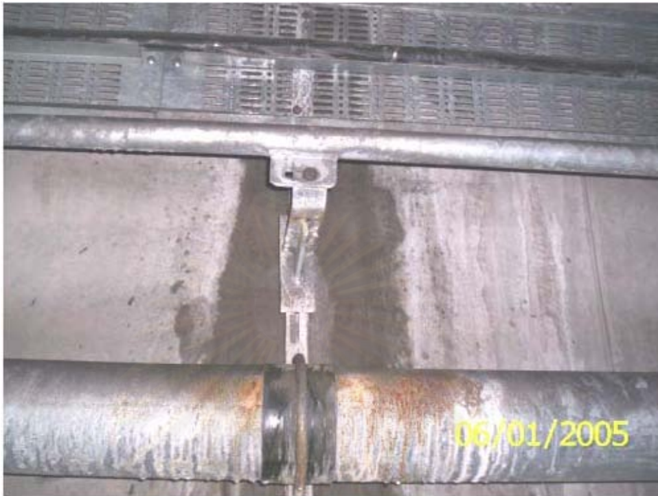
รูปที่ 5.20 น้ำรั่วซึมผ่านดาตคูโมงค์แล้วไหลผ่านที่รองรับท่อดับเพลิง (Hydrant Pipe Bracket)
