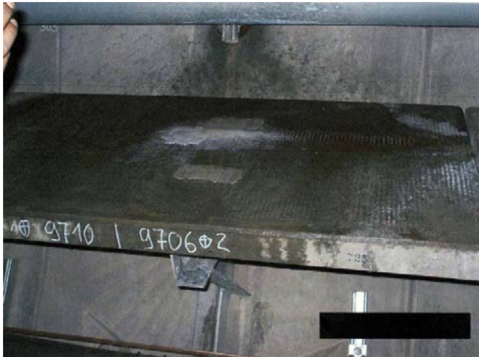
รูปที่ 5.18 น้ำรั่วซึมผ่านดาดคูโมงค์แล้วไหลผ่านที่รองรับทางเดินเท้าภายในคูโมงค์ (Walkway Bracket)
