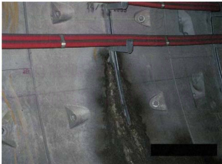
รูปที่ 5.19 น้ำรั่วซึมผ่านดาดคูโมงค์แล้วไหลผ่านที่รองรับ Cable (Cable Tray Bracket)
