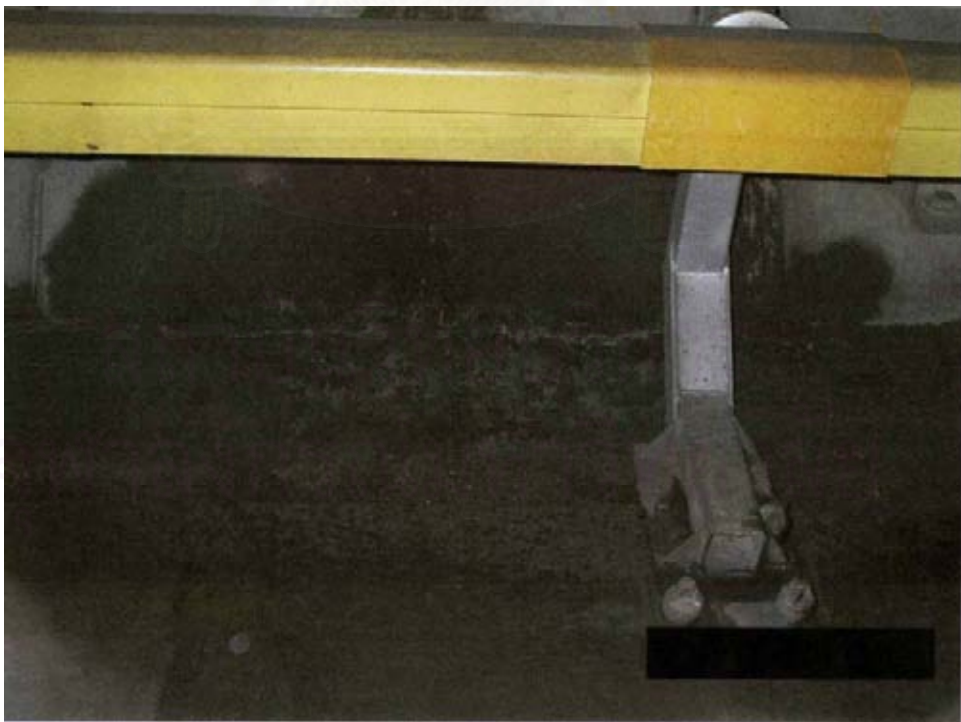
รูปที่ 5.17 น้ำรั่วซึมผ่านดาดคูโมงค์แล้วไหลผ่านที่รองรับรางจ่ายกระแสไฟฟ้า (Third Rail Bracket)
