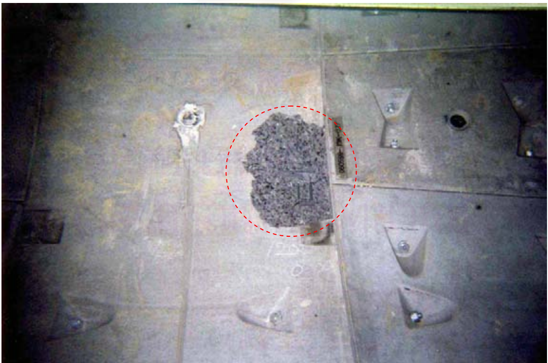
รูปที่ 5.24 ลักษณะของดาดอุโมงค์ที่คอนกรีตแตกหลุด
