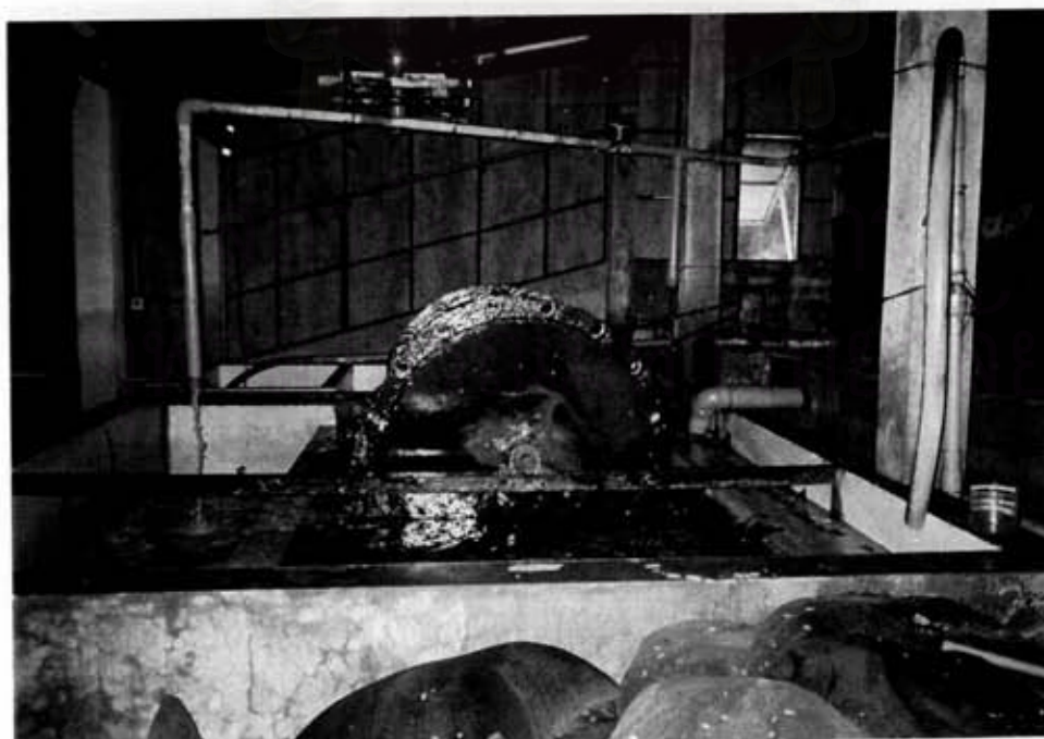
รูปที่ 36 บ่อน้ำบำบัดที่มีตัวกรองชีวภาพแบบไบโอดรัม (ภาพจากด้านข้าง)
