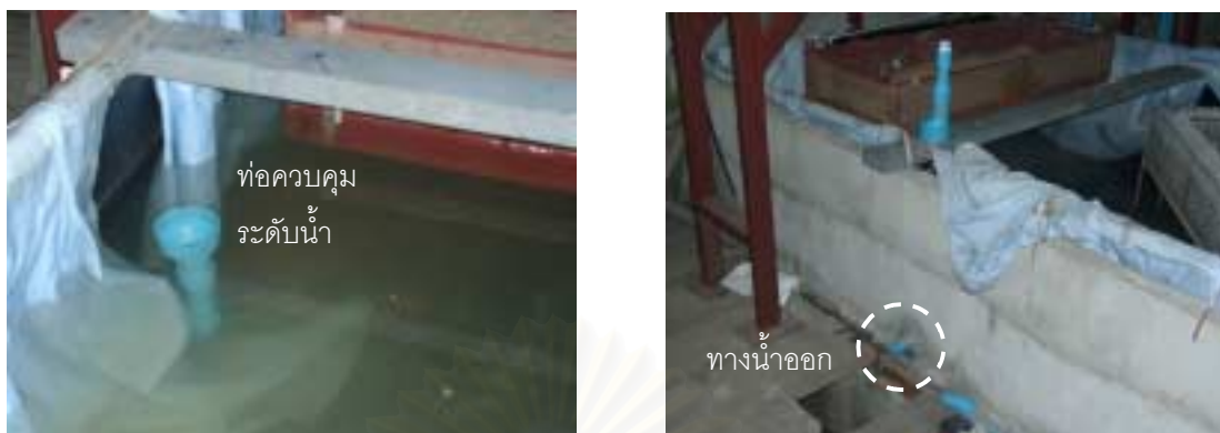
รูป 3-11 ท่อควบคุมระดับน้ำ
