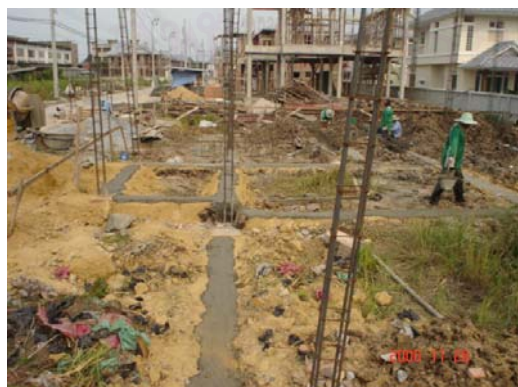
ภาพที่ 5.67 แสดงการเทคอนกรีตหยาบรองคานคอดิน
