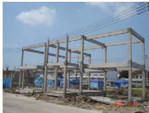
ภาพที่ 5.40 ติดตั้งโครงคาน ค.ส.ล. สำเร็จรูปแล้วทั้งหลัง
