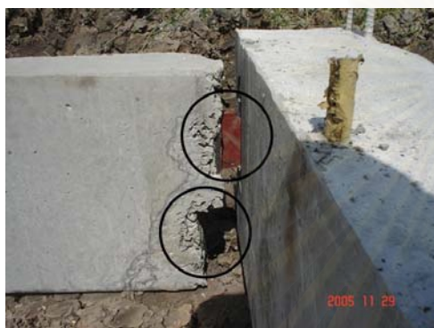
ภาพที่ 5.92 แสดงการต่อที่คลาดเคลื่อน
