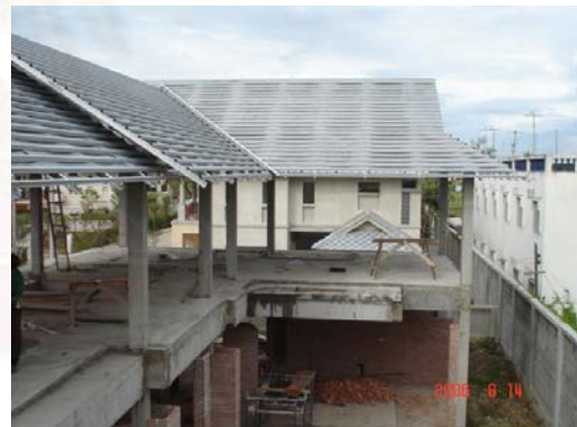
ภาพที่ 5.87 แสดงโครงหลังคาสำเร็จรูปที่ติดตั้งเสร็จ
