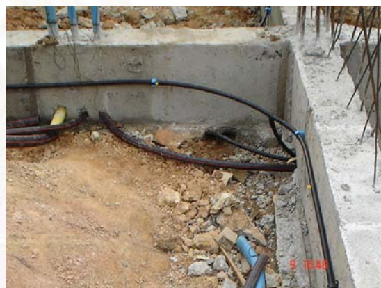
ภาพที่ 5.26 แสดงการวางตำแหน่งท่อระบบกำจัดปลวก
