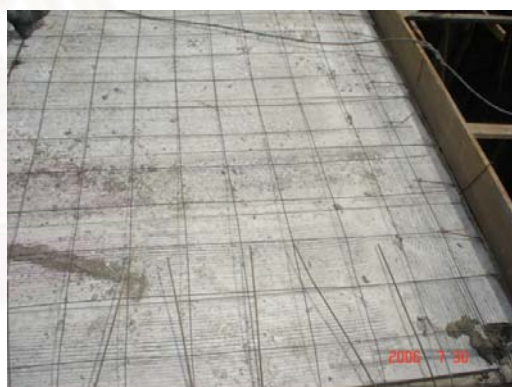
ภาพที่ 5.76 แสดงการวางตะแกรงเหล็กสำเร็จรูป
