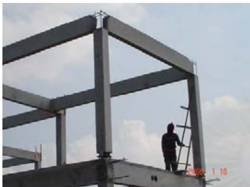
ภาพที่ 5.39 แสดงการติดตั้งคานหลังคาสำเร็จรูป
