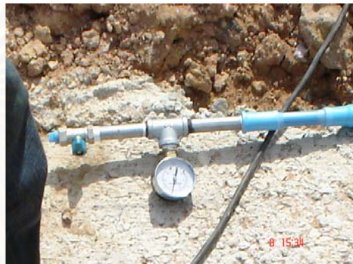
ภาพที่ 5.20 แสดงการอัดน้ำเพื่อตรวจการรั่วซึม
