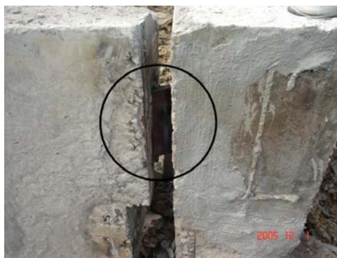
ภาพที่ 5.91 แสดงการต่อที่คลาดเคลื่อน
