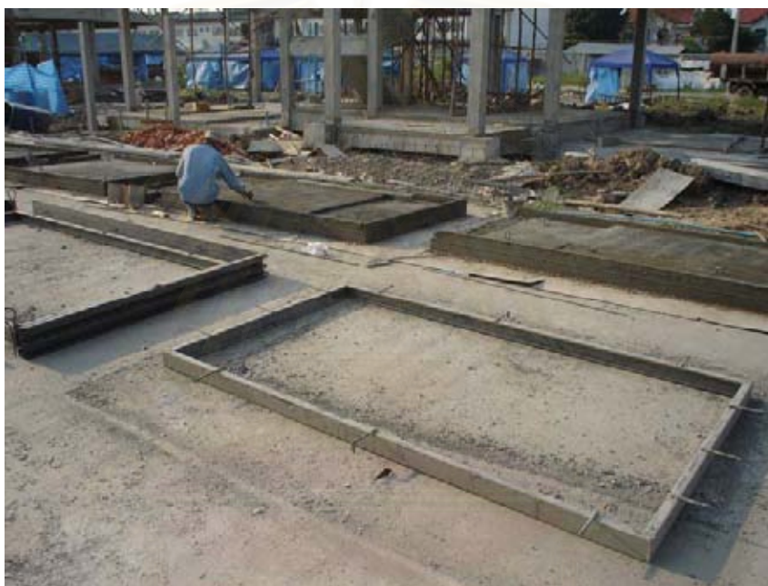
ภาพที่ 5.42 แสดงการหล่อถาดห้องน้ำ ค.ส.ล.สำเร็จรูป และถาดระเบียง ค.ส.ล.สำเร็จรูปที่หน้างาน
