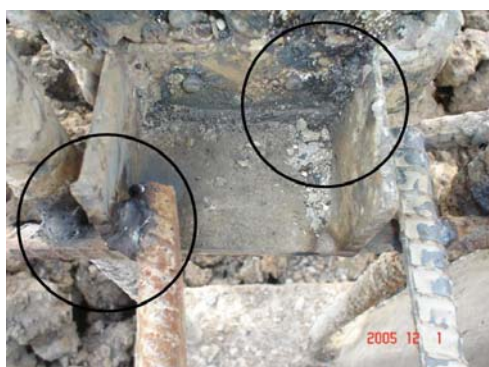
ภาพที่ 5.94 แสดงการเชื่อมเหล็กที่ไม่ได้คุณภาพ
