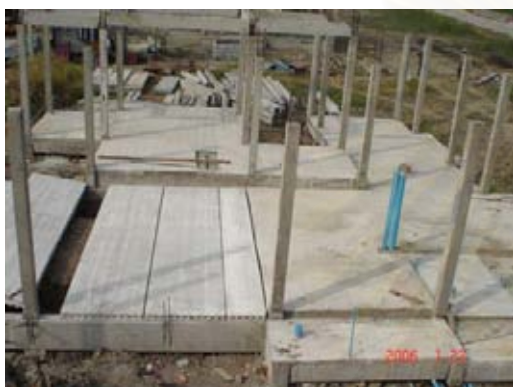
ภาพที่ 5.32 แสดงการติดตั้งแผ่นพื้นสำเร็จรูปชั้นล่าง
