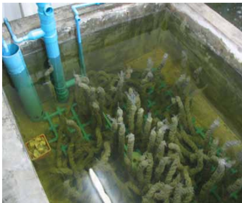
ภาพที่ 2-6 การติดตั้งตัวกรอง Bio-cord™ ภายในบ่อบำบัดน้ำจากบ่อเลี้ยงกุ้ง (รุ่งนภา สุทธิศรี, 2549)
