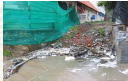
ภาพที่ 2.20 เศษขยะและตะกอนจากการก่อสร้างถูกปล่อยลงแหล่งน้ำ
