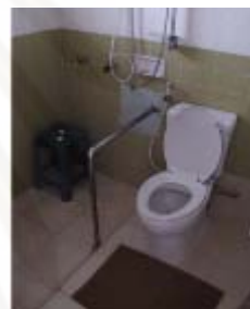
ภาพที่ 4.30 แสดงห้องน้ำที่ติดตั้งราวจับในภายหลัง
