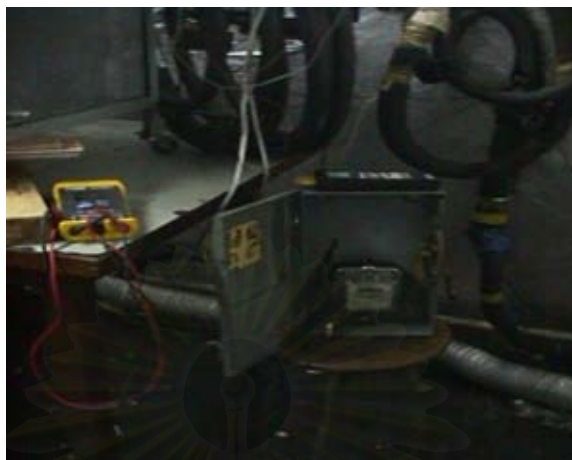
รูปที่ 4.6 มิเตอร์วัดกำลังไฟฟ้า
