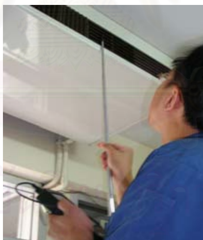
รูปที่ 4.22 แสดงการตรวจวัดความเร็วลมที่ช่องจ่ายลมเย็นของเครื่องปรับอากาศ
