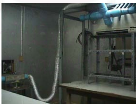
รูปที่ 4.26 ห้องควบคุมอากาศเย็น
