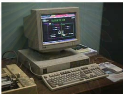
รูปที่ 4.30 คอมพิวเตอร์ของระบบควบคุมที่ห้องควบคุมอากาศ
