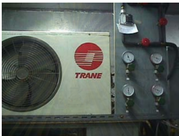
รูปที่ 4.8 อุปกรณ์วัดความดันสารทำความเย็น
