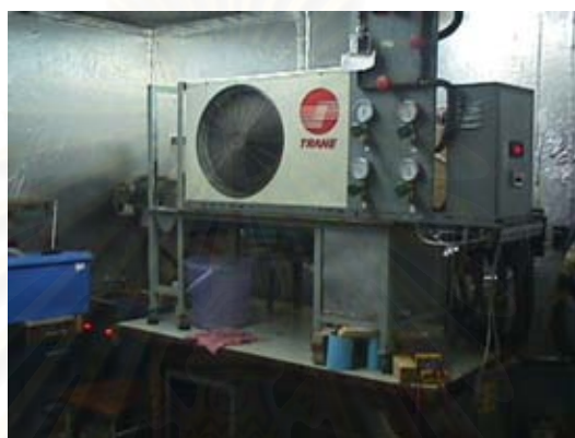
รูปที่ 4.25 ห้องควบคุมอากาศร้อน
