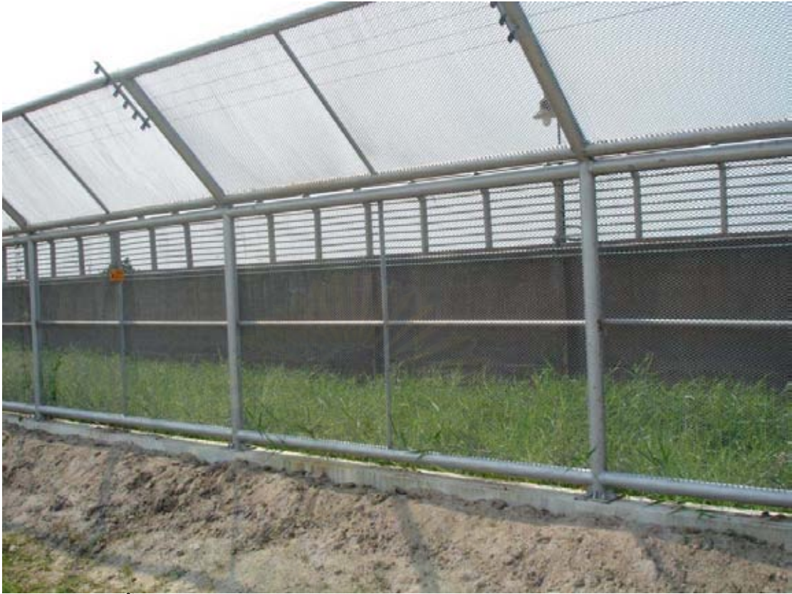
ภาพที่ 4 รั้วรอบบริเวณศูนย์ฝึกฯ บ้านกรุณา จะมีบ้านเตื่อนให้ระวางกระแสไฟฟ้าแรงสูง
