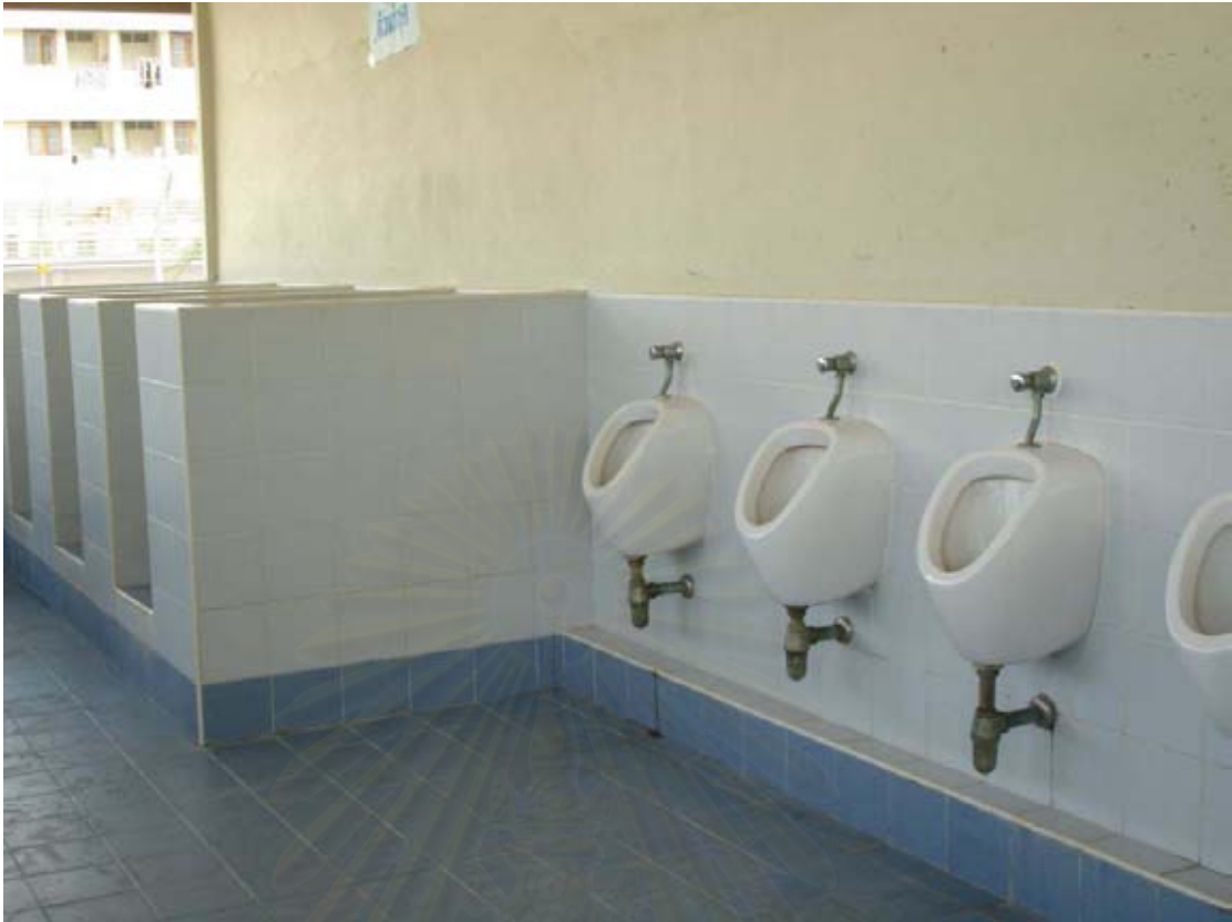
ภาพที่ 2 ห้องสุขาบริเวณอาคารหน่วยเรียน บ้านกรุดนา
