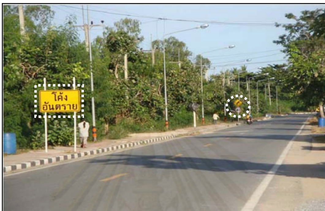
ภาพที่ ก.5 การติดตั้งป้ายรูปแบบ E บนทางโค้งราษฎร์มีกว้าง สายทาง ชบ.1008
