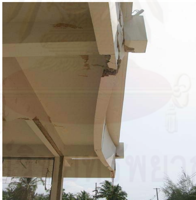
รูปที่ 3.12 คานบังแดดที่เสียหาย (Ruangrassamee และ คณะ, 2008)
