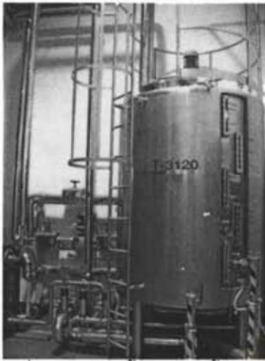
รูปที่ 5.1 การติดตั้งหม้อต้มน้ำร้อนในโรงงาน
