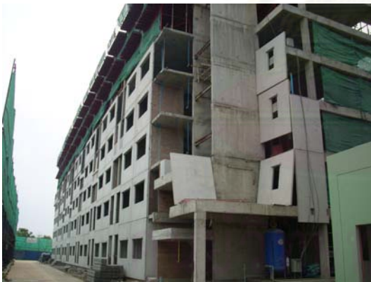
ภาพที่ 5.190 แสดงการแขวนผนัง ค.ส.ล. สำเร็จรูป
