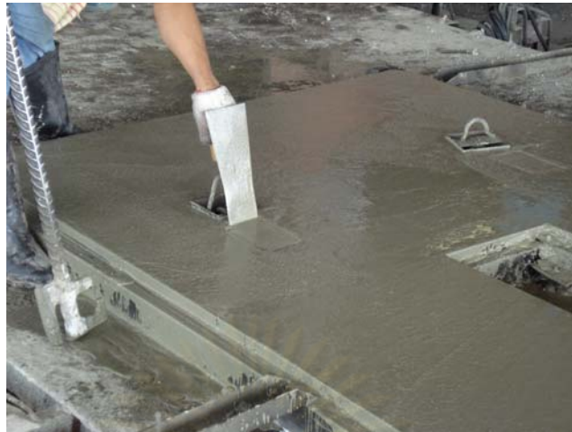
ภาพที่ 5.65 การชูดน้ำปูนบริเวณผิวหน้า Plate เหล็ก และรอตงผิวหน้าคอนกรีตอีก 3 ครั้ง
