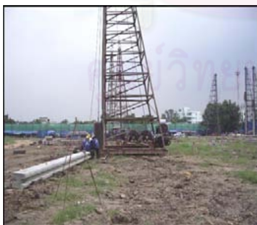
ภาพที่ 5.146 แสดงการตอกเสาเข็มคอนกรีตอัดแรงรูปตัวไอ ขนาด 0.35 X 0.35 เมตร
