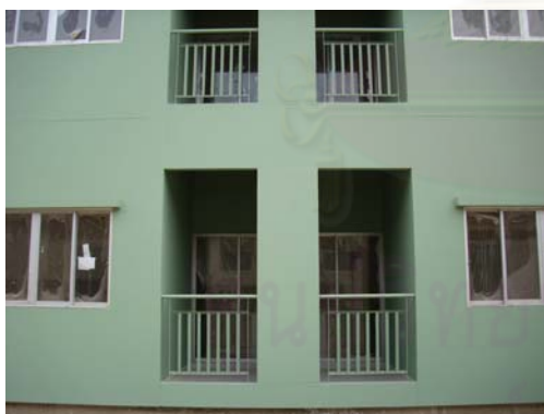
ภาพที่ 5.248 แสดงงานติดตั้งประตู หน้าต่าง
