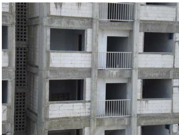
ภาพที่ 5.136 แสดงงานผนังก่ออิฐภายนอกอาคาร
