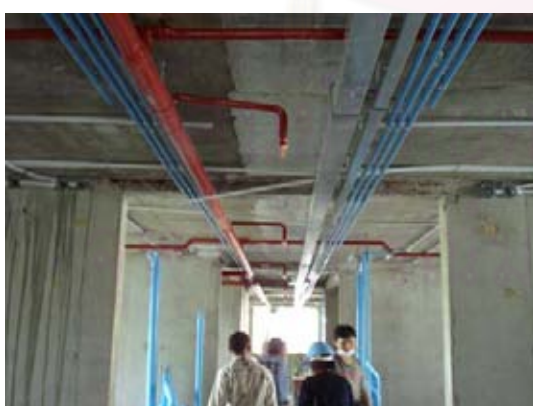
ภาพที่ 5.141 แสดงงานระบบบริเวณทางเดิน
