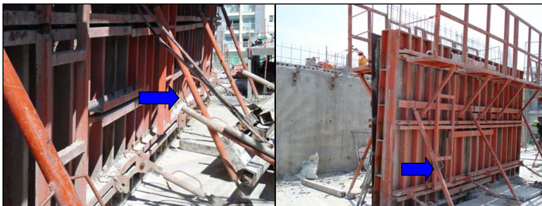
ภาพที่ 5.116 แสดงการติดตั้งแบบเหล็กและค้ำยันด้วยพรีค้ำที่ติดมากับแบบเหล็ก
