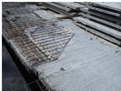
ภาพที่ 5.18 พื้นสำเร็จรูปที่ต่างระดับ
