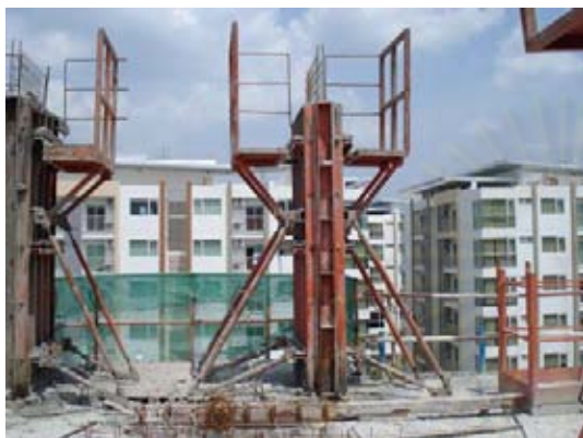
ภาพที่ 5.117 แสดงแบบหล่อที่พร้อมเทคอนกรีต
