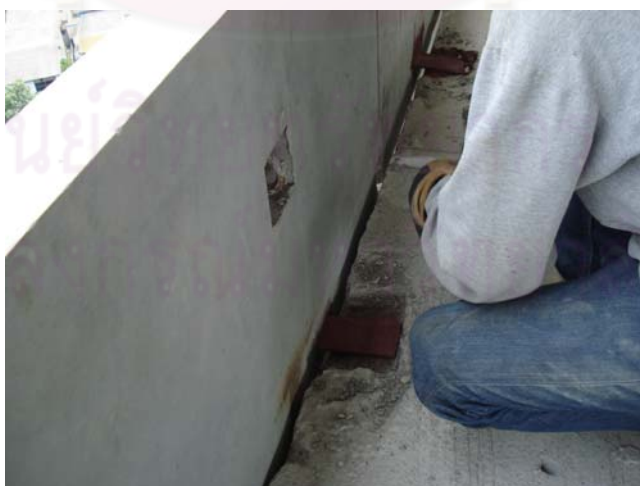
ภาพที่ 5.271 แสดงการเทคอนกรีตพื้นผิดระดับ ทำให้ Insert Plate อยู่ต่ำลงจากระดับพื้นมาก ทำให้ต้องสกัดพื้น
