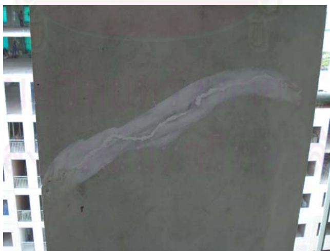
ภาพที่ 5.272 แสดงความเสียหาย ที่เกิดขึ้นกับผนัง ค.ส.ล. สำเร็จรูป
