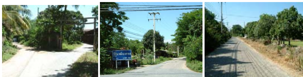
ปัญหาทางสัญจรบริเวณถนนบ้านหมี่-เสาชง คอนข้างชำรุด ขรุขระ
