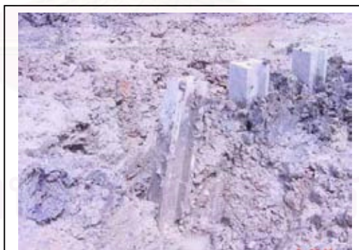
ภาพที่ 4.181 เข็มอาคารเคลื่อนตัว
