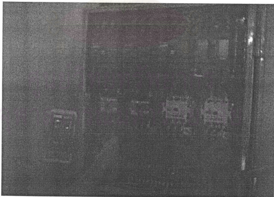
รูปที่ 4.14 การวัดกำลังไฟฟ้าที่แผงควบคุมไฟฟ้า
