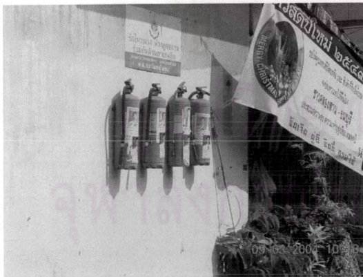
4-15 แสดงถึงถังดับเพลิงเคมีชนิดแห้ง ขนาด 15 ปอนด์ที่ติดตั้งไว้ทั่วบริเวณในชุมชน
