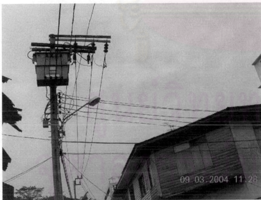
ภาพที่ 4-4 แสดงหม้อแปลงไฟฟ้าในชุมชน
