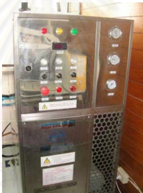
รูปที่ 4.11 เครื่องทำน้ำเย็น (Chilled Water Machine)
