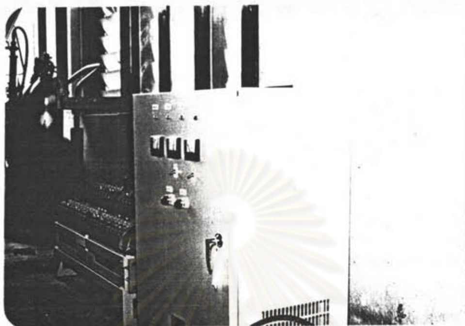
รูปที่ 2.24 แสดงรูปถ่ายของส่วนจ่ายไฟต่อเนื่อง
