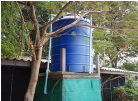
รูปที่ 3.3 ถังเก็บน้ำขนาด 1 ตันจะให้มีน้ำสูบเข้าไปเก็บไว้ในถังแล้วปล่อยน้ำเข้าระบบ
