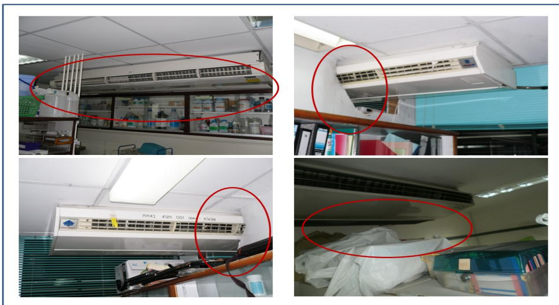
ภาพที่ 5.1 แสดงสภาพทรุดโทรมของอุปกรณ์ในระบบปรับอากาศ
