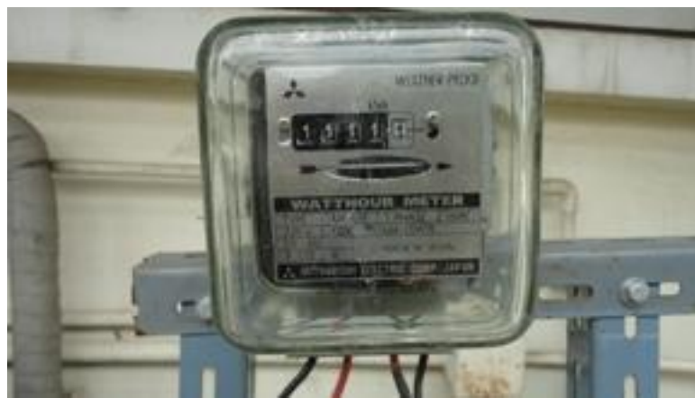
รูปที่ 4.2 มิเตอร์วัดกำลังไฟฟ้า
