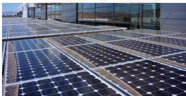
รูปภาพที่ 4.20 แสดงการใช้พลังงานทดแทนจากการใช้ Solar Cell
