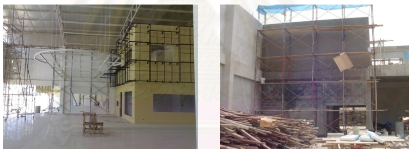
รูปภาพที่ 4.17 แสดงการก่อผนังอาคารกรณีศึกษาร้านโฮมมาร์ท สมาร์ทโฮมโปรดักส์
