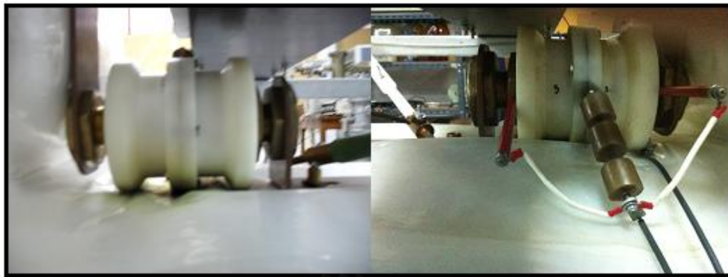
รูปที่ 4.1.6 ภาพแสดงสปาร์กแก๊ปเมื่อทำการติดตั้งแล้วเสร็จ
