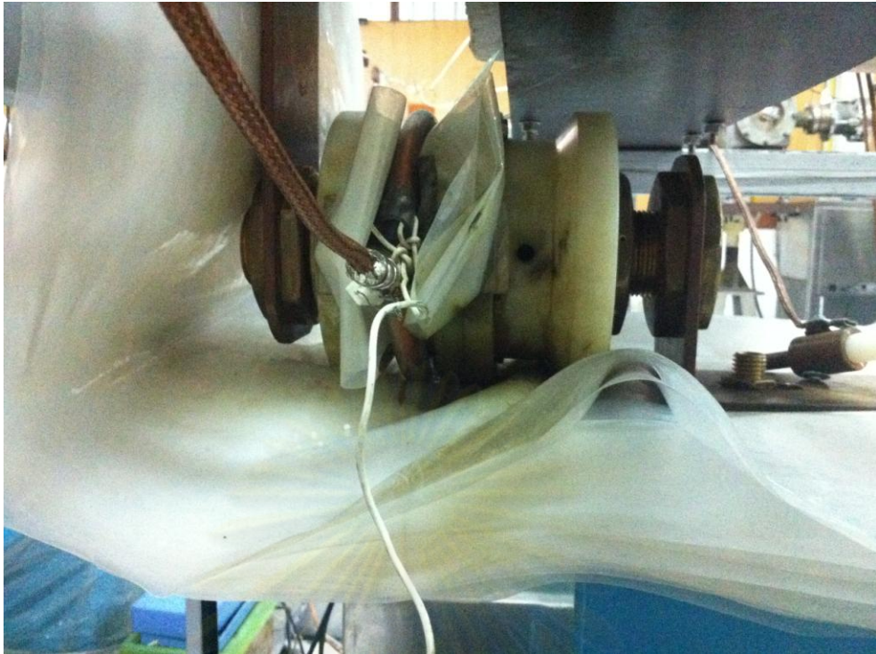
รูปที่ 4.2.4 ภาพการต่อขดลวดโรโกวสกีที่รอบหัวไฟฟ้าในการทดลองจริง
