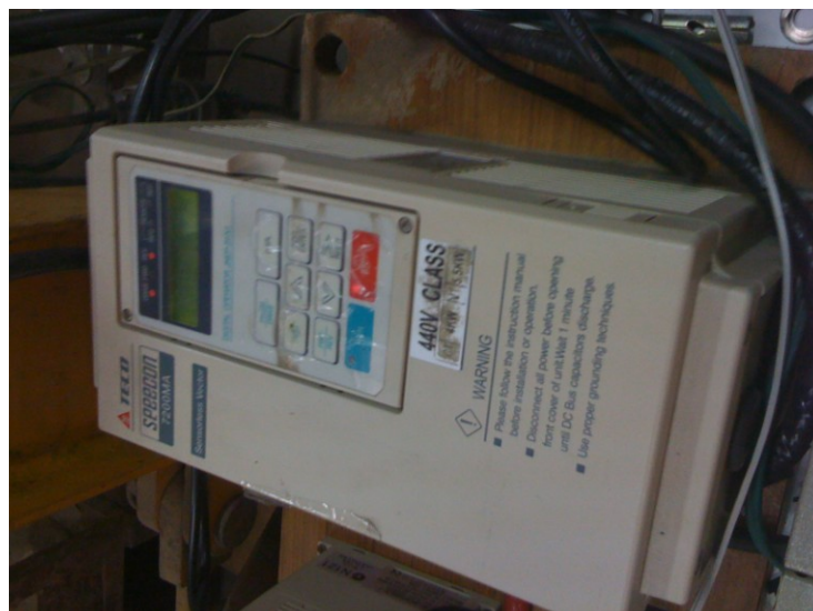
ภาพที่ จ.2 Inverter
