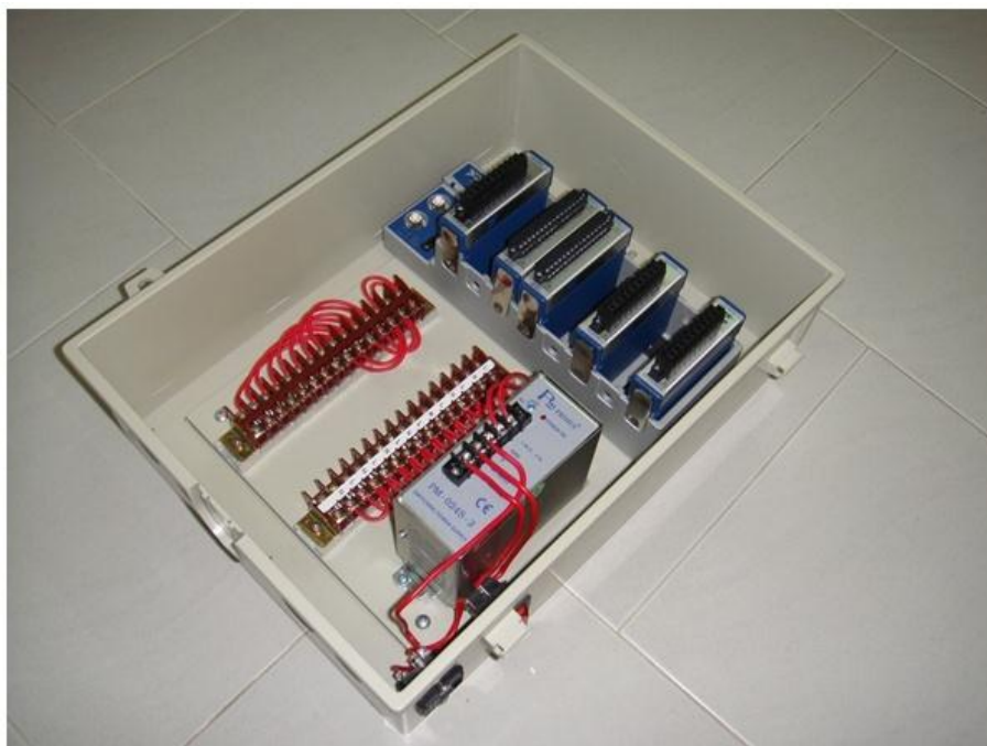
ภาพที่ 5.17 กล่องควบคุม
