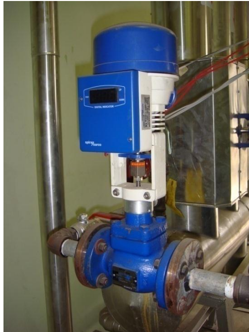
ภาพที่ 4.4 วาล์วควบคุม
