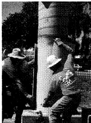
รูปที่ 2.21 การซ่อมแซมเสาด้วยการติดตั้งแผ่นเสริมกำลังแบบ individual shell (Ma และคณะ, 1999)
