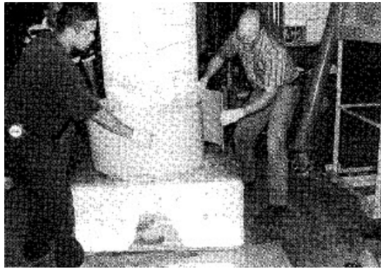
รูปที่ 2.20 การซ่อมแซมด้วยวิธีการใช้ epoxy และติด prefabricated jacket โดย (Ma และคณะ, 1999)
