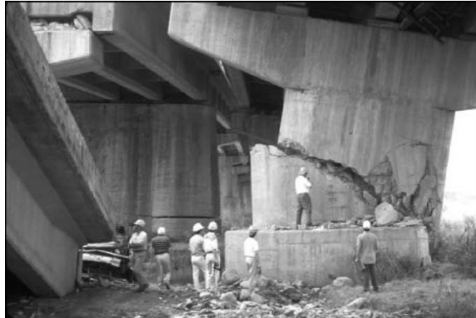
รูปที่ 2.10 ความเสียหายจากแรงเฉือนที่เสาของสะพาน Wu Shi (Christopoulos และคณะ, 2002)
