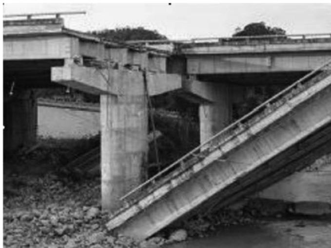
รูปที่ 2.7 ความเสียหายเนื่องจากคานสะพานหล่นจากที่รองรับ ของสะพาน Shi Wei (Christopoulos และคณะ, 2002)
