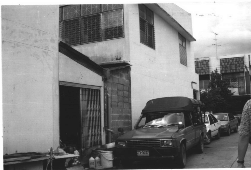
รูปที่ 3 พื้นที่ว่างด้านหลังทาวน์เฮาส์ ซึ่งตามกฎหมายระบุพื้นที่ว่าง 2.00 เมตร เพื่อใช้เป็น ทางหนีไฟ แต่ปรากฏว่าโดยทั่วไปแล้วนิยมต่อเติม เพื่อใช้เป็นพื้นที่ปรุงอาหารและซักล้าง
