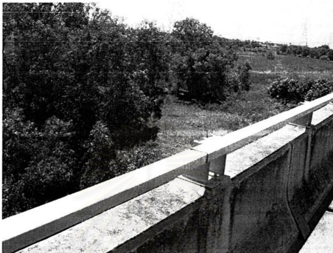
รูปที่ 7.6 ราวเหล็กเดิมที่ติดตั้งอยู่บนขอบข้างทางยกระดับ
