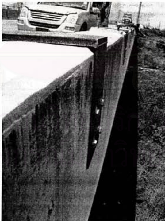
รูปที่ 7.8 การติดตั้งแผ่นเหล็กซึ่งเป็นฐานรองรับแผงกันเสียง
