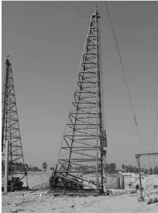
รูปที่ 2.2 การตอกเสาเข็มวิธี Drop hammer (บริษัท สามัคคีผลิตภัณฑ์คอนกรีต จำกัด , 2554 : ออนไลน์ )
