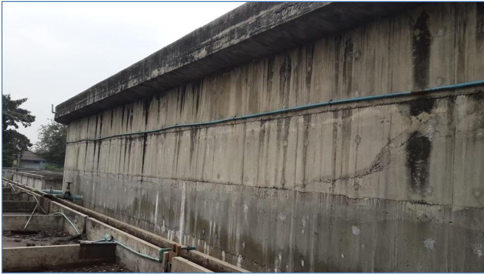
ภาพที่ 3 - 3 ระบบบำบัดน้ำเสียแบบไร้อากาศ บ่อยูเอเอสบีสำหรับฟาร์มขนาดกลาง (MC-UASB)
