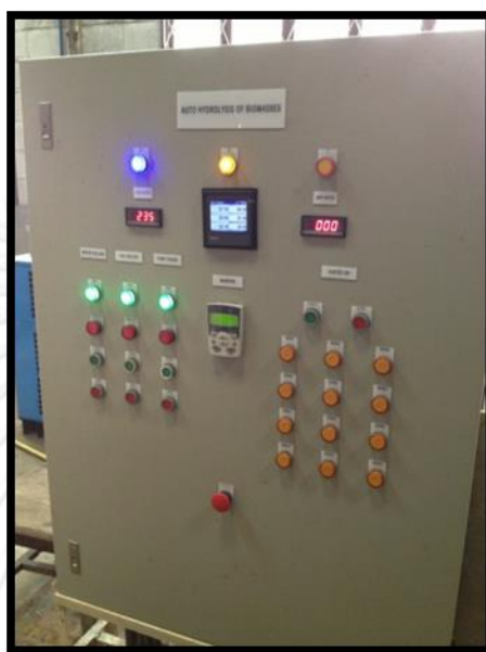
รูปที่ 3-6 ตู้ควบคุม
