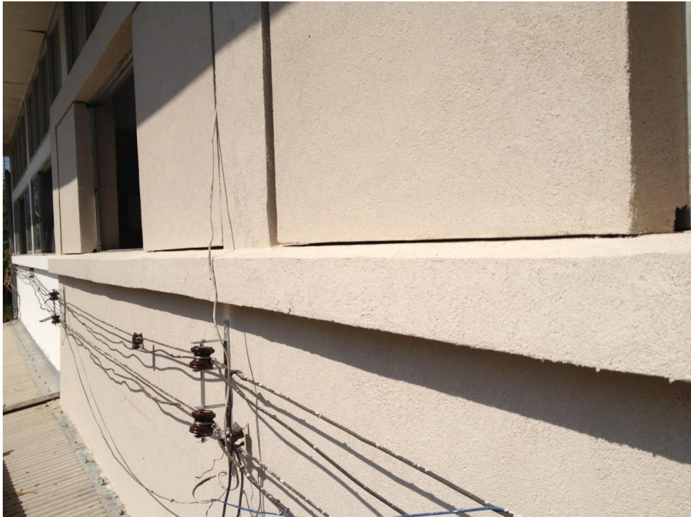
รูปที่ 4 - 34 แสดงผนังภายนอกห้องหลังการติดตั้ง (บันทึกภาพวันที่ 27 ธ.ค. 55)
