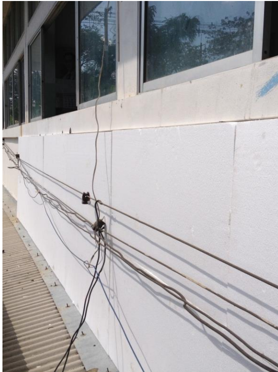
รูปที่ 4 – 26 แสดงถึงฉนวนที่ถูกติดตั้งเต็มพื้นที่ (บันทึกภาพวันที่ 18 ธ.ค. 55)
