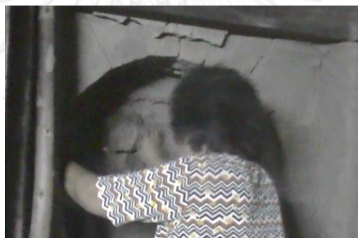
รูปที่ 3.147 การใช้ก้อนอิฐและยาดินประตุอุดช่องคูไฟบริเวณประตูข้างเตา
