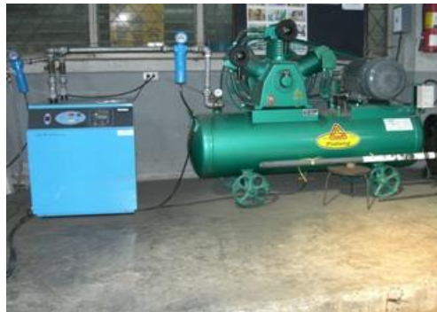
รูปที่ 3.9 เครื่องอัดอากาศ พร้อมอุปกรณ์ทำความเย็นอากาศและระบบกำจัดน้ำในอากาศ
