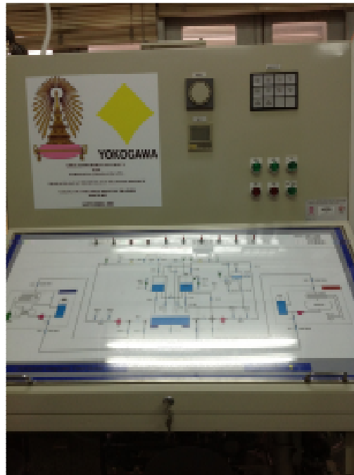
รูปที่ ก.4 หน่วยติดต่อและปฏิบัติงานของพนักงานแบบแผงควบคุม
