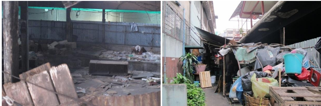
รูปที่ 4-22 สภาพปัจจุบันภายใน และด้านข้างตลาดปรีะกา ซึ่งปัจจุบันปิดรกร้าง
