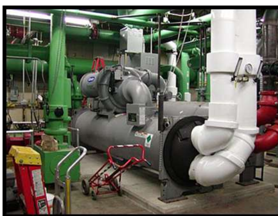
รูปที่ 2.3 เครื่องทำน้ำเย็นแบบระบายความร้อนด้วยน้ำ
