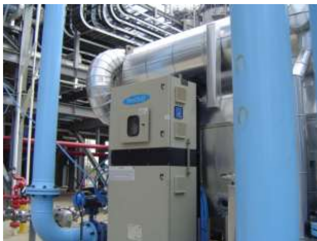
รูปที่ 4.39 ตู้ที่ทำการอ่านค่าอุณหภูมิน้ำเย็นและค่าอุณหภูมิน้ำหล่อเย็น
