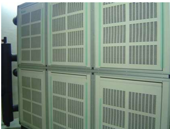
รูปที่ 4.30 ลักษณะของช่องลมจากกลับเข้าเครื่องส่งลมเย็นที่ทำการติดตั้งใหม่
