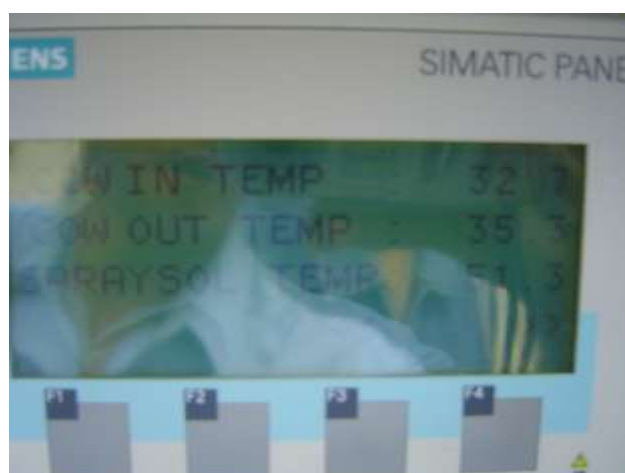
รูปที่ 4.38 ค่าอุณหภูมิ น้ำหล่อเย็นที่อ่านได้จากหน้าปัดเครื่องทำน้ำเย็นแบบดูดซึม
