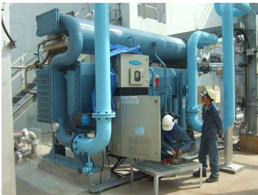
รูปที่ 4.17 เครื่องทำความเย็นแบบดูดซึม
