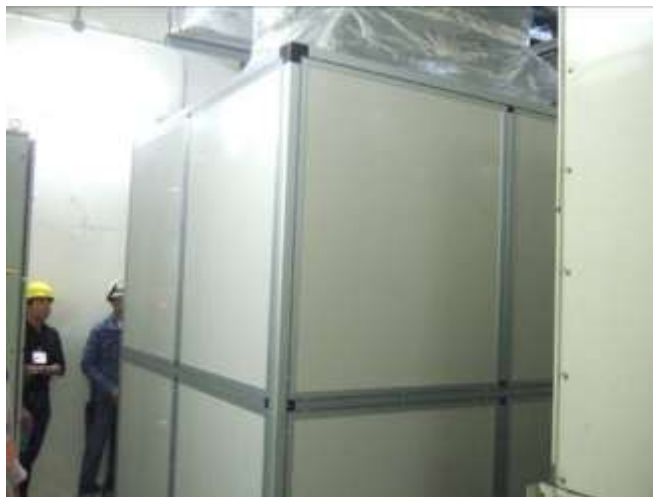
รูปที่ 4.19 ISBL HVAC AHU ขนาด 211,849 kcal/h
