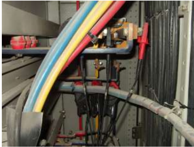
รูปที่ 4.28 การติดตั้งอุปกรณ์วัดกำลังไฟฟ้าที่ใช้ในส่วน of เครื่องทำน้ำเย็นแบบดูดซึม
