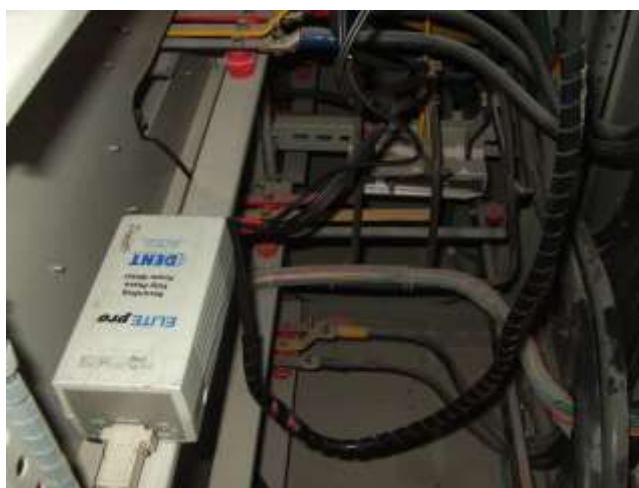
รูปที่ 4.27 การติดตั้งอุปกรณ์วัดกำลังไฟฟ้าของเครื่องส่งลมเย็นที่ติดตั้งเพิ่มขึ้นมาใหม่
