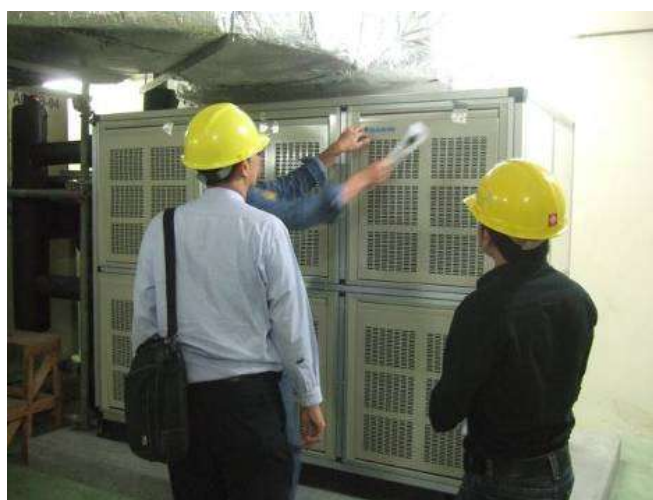
รูปที่ 4.21 Laboratory AHU ขนาด 187,043 kcal/h
