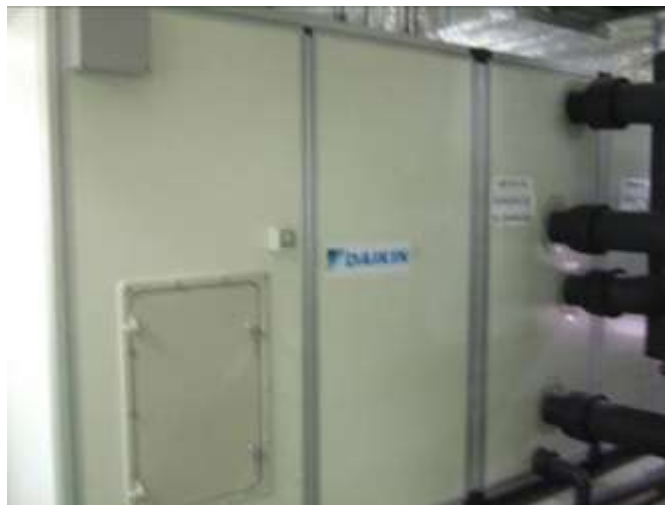
รูปที่ 4.20 Control room AHU ขนาด 214,893 kcal/h
