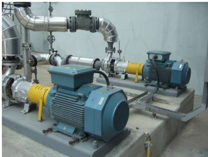
รูปที่ 4.18 Chilled Water Pump
