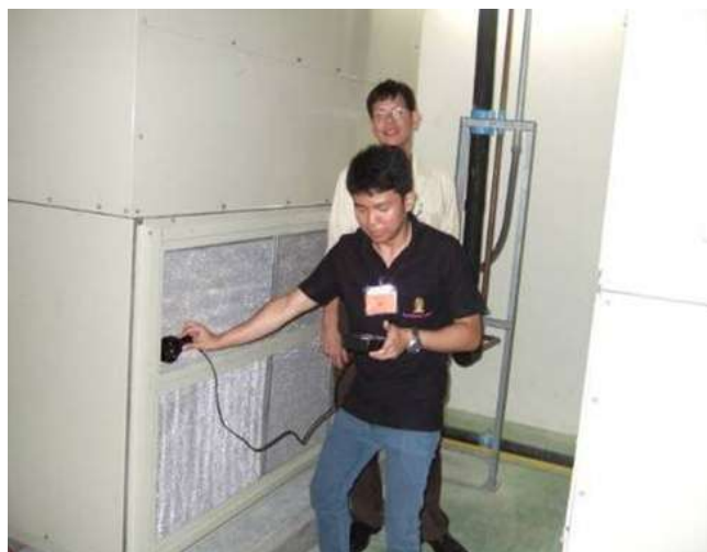
รูปที่ 4.12 การตรวจวัดปริมาณลมอากาศเย็นเข้าเครื่องส่งลมเย็น
