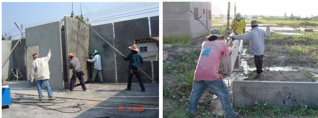
รูปที่ 5.23 และรูปที่ 5.24 ช่างติดตั้งชิ้นส่วนคอนกรีตสำเร็จรูปจัดผนังและคานให้ตรงแนว
