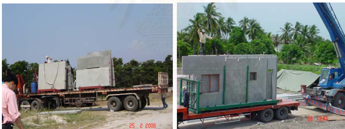
รูปที่ 3.1 - รูปที่ 3.2 รถเทรลเลอร์ขนส่งชิ้นส่วนคอนกรีตสำเร็จรูป
