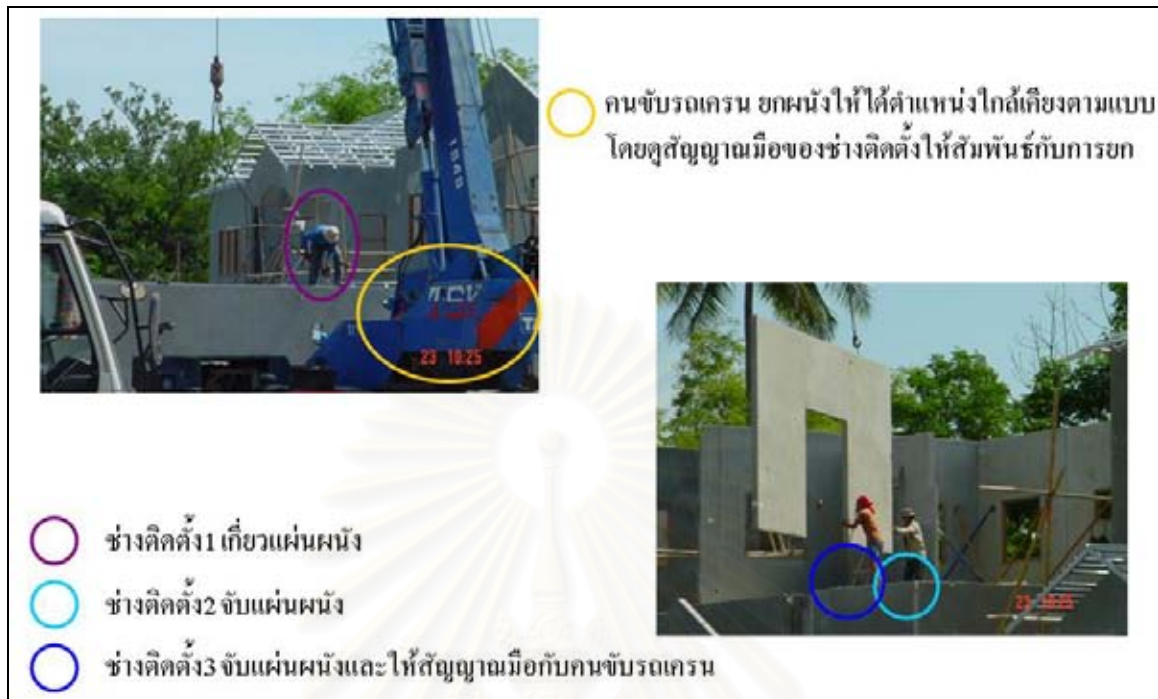
รูปที่ ค.6 งานติดตั้งผนังคอนกรีตสำเร็จรูป
