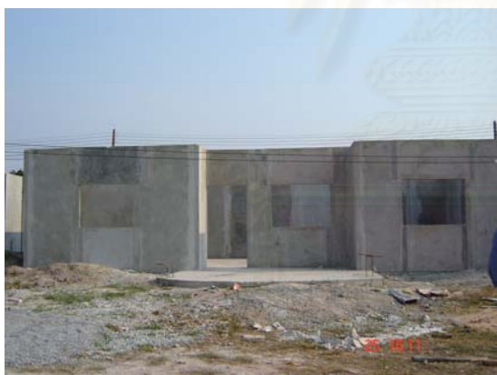
รูปที่ 3.39 บ้านชั้นเดียวเมื่อติดตั้งผนังเสร็จแล้ว
