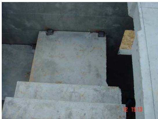
รูปที่ 3.29 การติดตั้งบันไดคอนกรีตสำเร็จรูป
