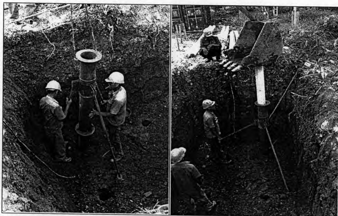
รูปที่ 5.6 ขั้นตอนการติดตั้งเครื่องมือและระหว่างปฏิบัติงาน
