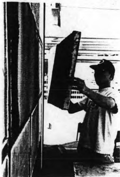
(9) นำฉนวนโคมที่ได้ฉาบส่วนผสมไปติดกับผนังก่ออิฐฉาบปูน
