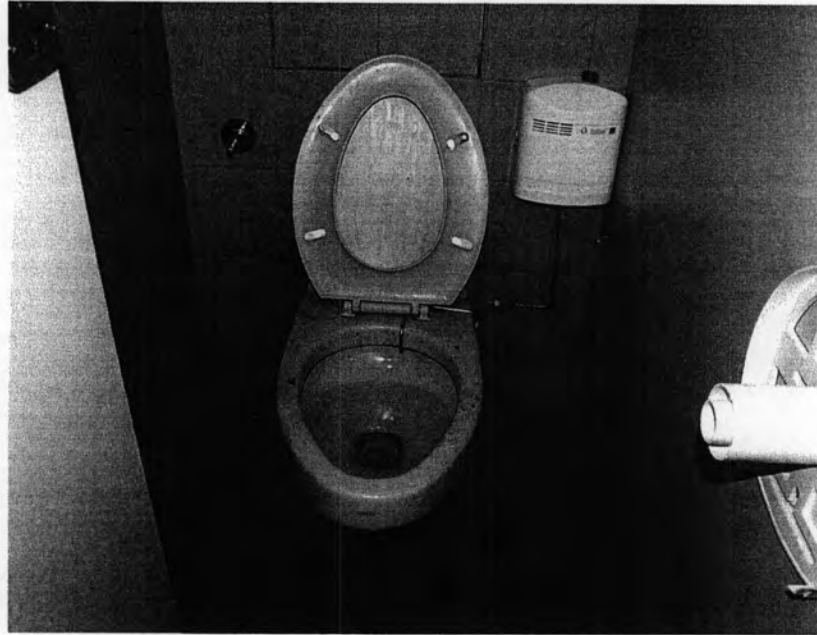
รูปภาพที่ 5-10 ปัญหาพื้นห้องน้ำสกปรกเกิดจากน้ำเอ่อล้นจากโถส้วม
