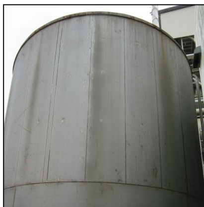
รูปที่ 3.5 ถังเก็บน้ำปราศจากแร่ธาตุ (Demineralized water Tank) ระบบการแลกเปลี่ยนไอออนมีการทำงาน 4 ขั้นตอนต่อเนื่องกันดังนี้
