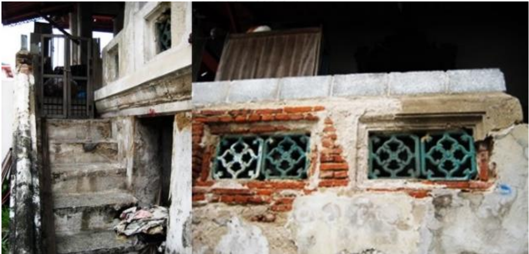
ภาพที่ 13 และ ภาพที่ 14 ภาพแสดงส่วนที่ชำรุดเสียหายของบันไดและผนังกระเบื้องของหอพระไตรปิฎกวัดเทพธิดาราม (ที่มาของภาพ โครงการอนุรักษ์หอพระไตรปิฎกวัดเทพธิดารามวรวิหาร กรุงเทพมหานคร)
