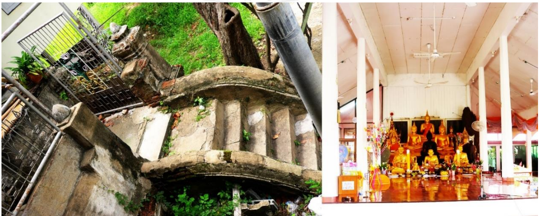
ภาพที่ 45 และ ภาพที่ 46 ภาพแสดงบันไดทางขึ้นหมู่กุฏิก่อนการบูรณะหมู่กุฏิ และภาพแสดงองค์พระประธานประจำหมู่กุฏิวัดสะแก
