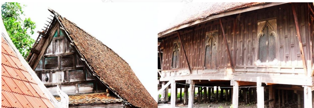
ภาพที่ 107 และ ภาพที่ 108 ภาพแสดงความเสื่อมสภาพของหลังคาเรือนตำหนักทอง และภาพแสดงการทรุดตัวของเรือนตำหนักทอง
